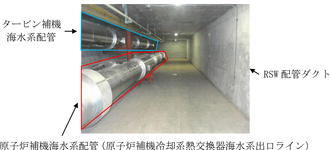
第 2-3 図 対象下位クラス配管と下位クラス施設の現場状況（例①）
