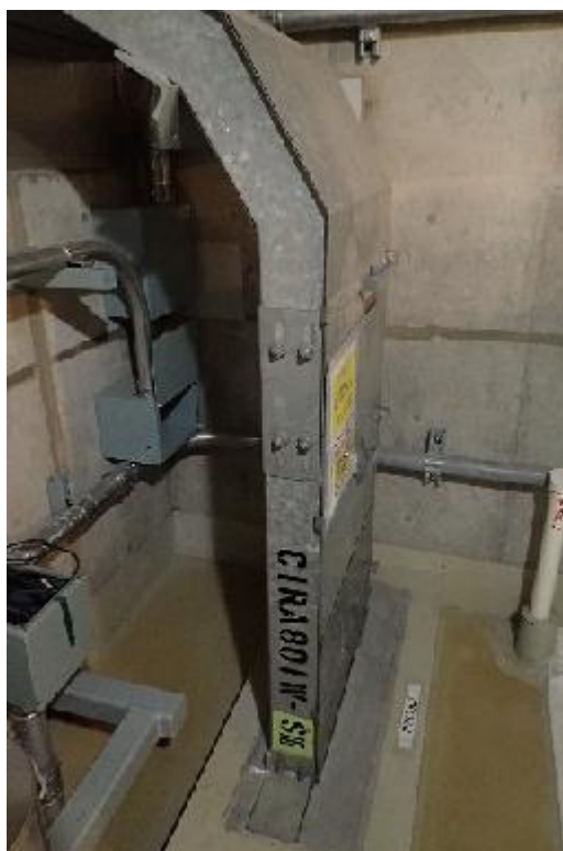
第2図 ケーブルトレイ床貫通部外観
