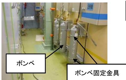
美浜3号機 中間建屋 ハロン 1301 (消火設備)
