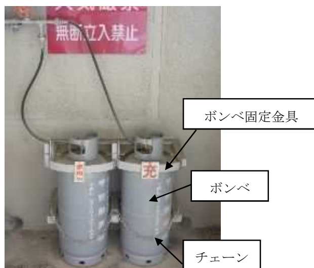
3号機 補助ボイラ建屋 補助ボイラ用プロパンガス
