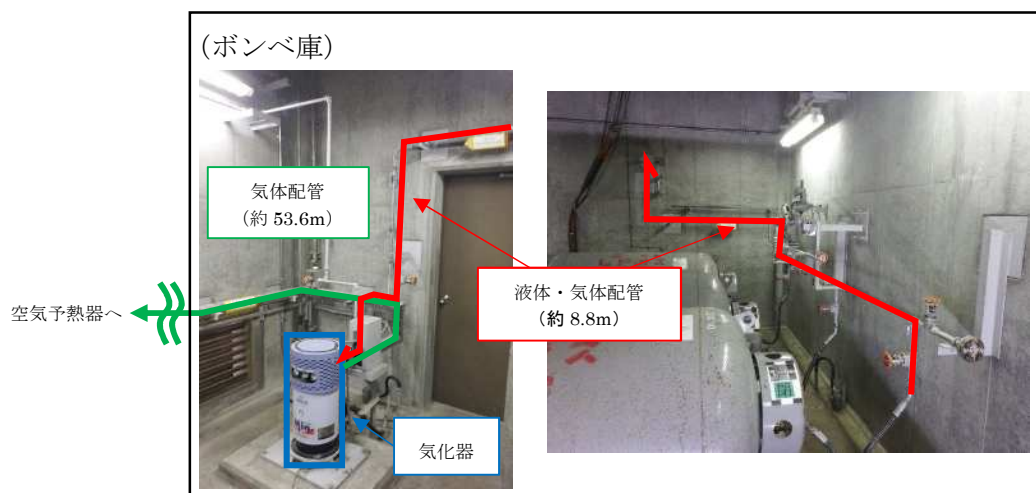
図 3・4号機雑固体焼却設備のプロパンポンベ加温器回りの現場状況
