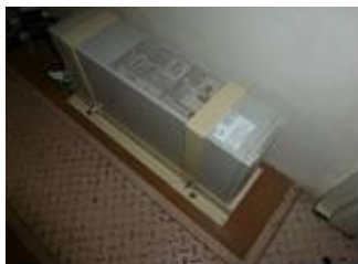
(無停電電源装置の写真)
