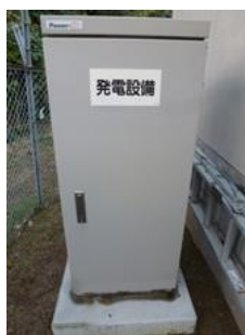
(非常用発電機の写真)
