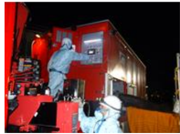
ポンプ起動操作（夜間）
