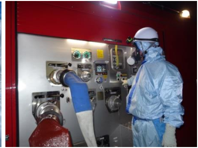
ポンプ起動操作（夜間）
