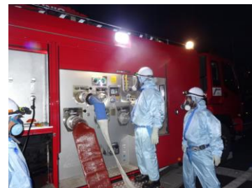
ポンプ起動操作（夜間）
