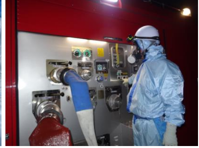
ポンプ起動操作（夜間）
