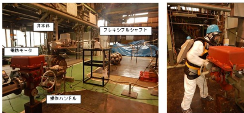
ベント操作（遠隔手動弁操作機構）
