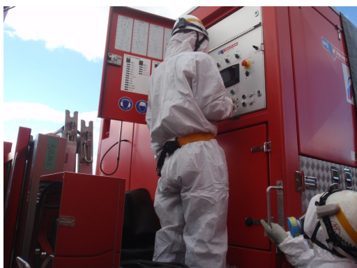
ポンプ起動操作
