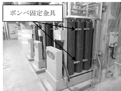
液化炭酸ガス (1号DG建屋)
