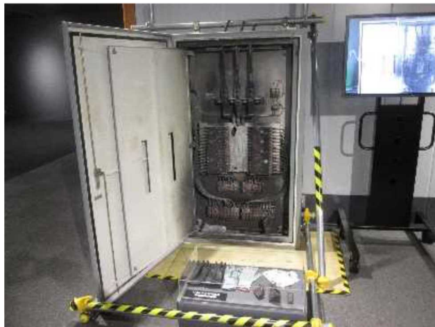
柏崎刈羽5号炉 定検用分電盤火災
