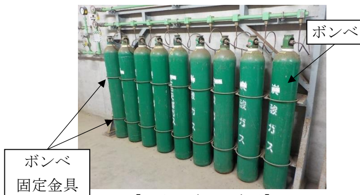
【7号炉ポンベ建屋】 二酸化炭素ポンベ
