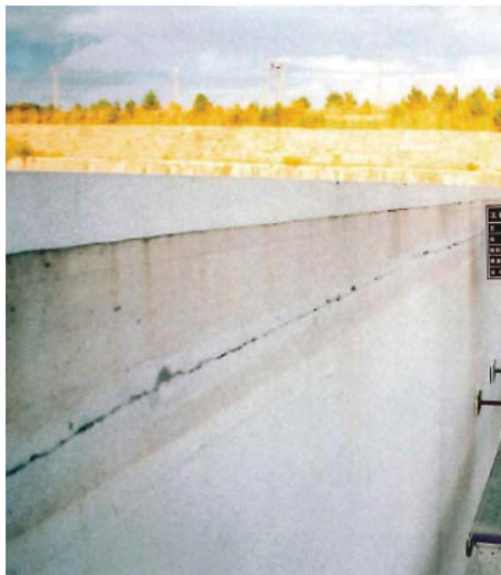
写真1 覆い側部のひび割れ状況
