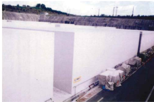
写真4 表面被覆状況(1号4-C)
