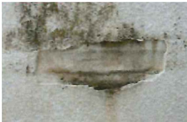
写真 10 表面被覆の剥離(1号 4-C 覆い側部)
