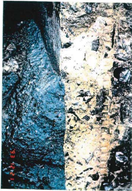
第 13 図 セメント系充填材部分の解体状況(側壁コンクリートとの境界部の状況)
