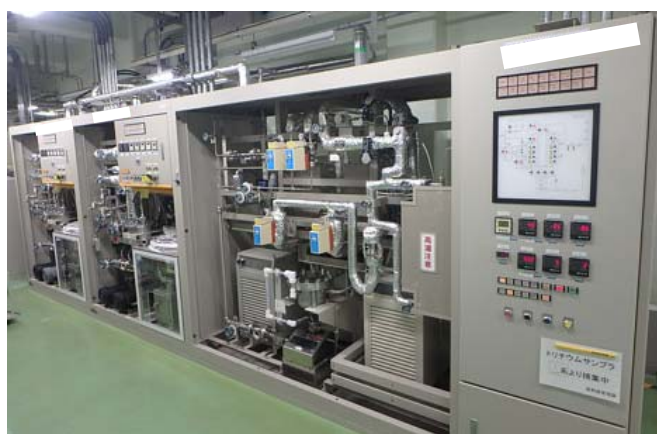
第 2 図 北換気筒（使用済燃料受入れ・貯蔵建屋換気筒）の排気 モニタリング設備
