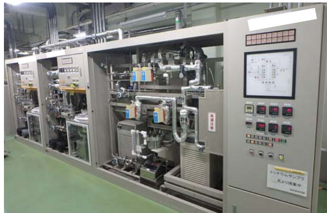
第4図 排気モニタリング設備（北換気筒（使用済燃料受入れ・貯蔵建屋換気筒））の外観
