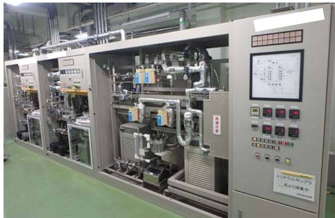
第 1.2.2 図 排気モニタリング設備の外観
