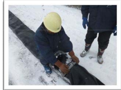
建屋外ホース接続 (300A)
