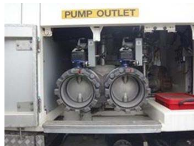
大型移送ポンプ車吐出部 可搬型建屋外ホース接続箇所 (300A)
