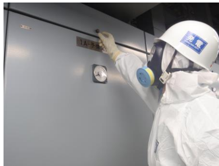
インターロック解除処置
