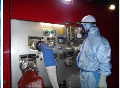
ポンプ起動操作（夜間）
