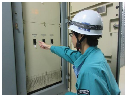
電源切替操作
