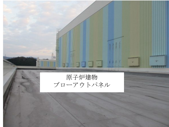
原子炉建物ブローアウトパネル
