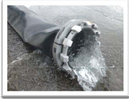
建屋外ホース接続箇所 (300A)
