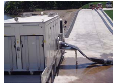
可搬型建屋外ホース接続 (300A)
