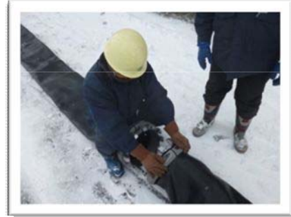
建屋外ホース接続 (300A)
