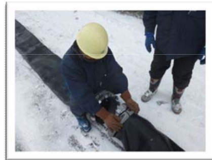
建屋外ホース接続 (300A)
