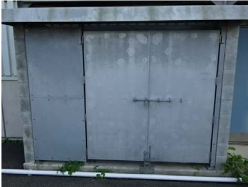
補助ボイラLPGボンベ庫
