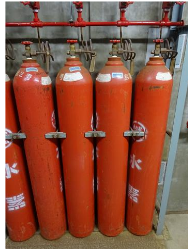
水素ガスボンベの固縛状況 (水素・炭酸ガスボンベ室)
