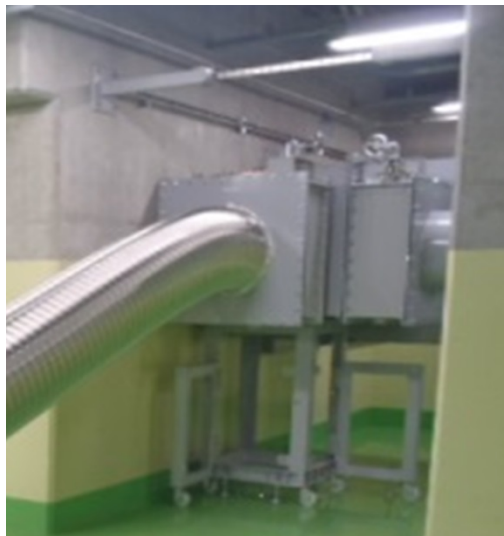
(可搬型設備と常設設備はフランジにより接続している)
