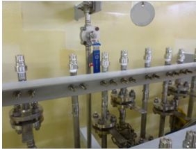
接続口 20A配管
