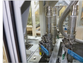
接続口 40A配管
