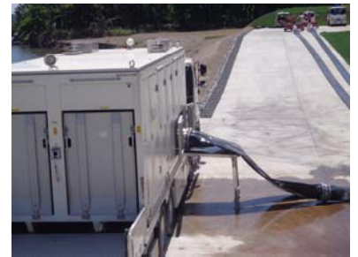
可搬型建屋外ホース接続 (300A)
