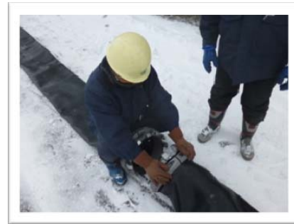
建屋外ホース接続 (300A)
