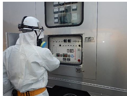
高圧発電機車での作業
