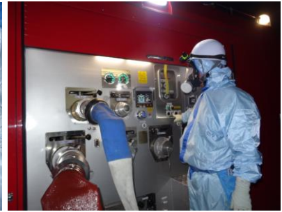
ポンプ起動操作（夜間）
