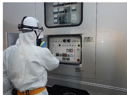
高圧発電機車での作業
