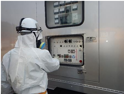
高圧発電機車での作業
