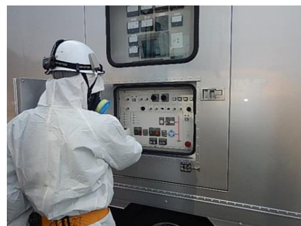
高圧発電機車での作業
