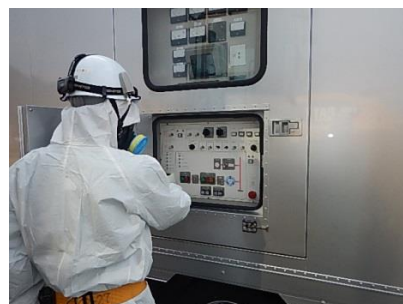
高圧発電機車での作業
