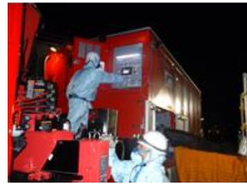
ポンプ起動操作（夜間）
