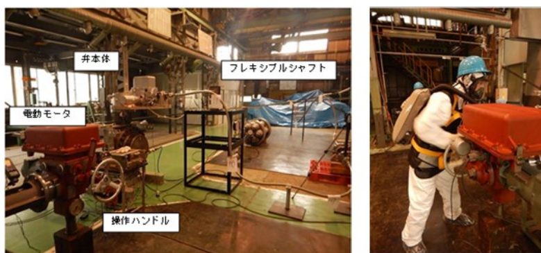
ベント操作（遠隔手動弁操作機構）
