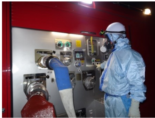
ポンプ起動操作（夜間）
