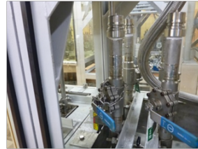
接続口 40A配管
