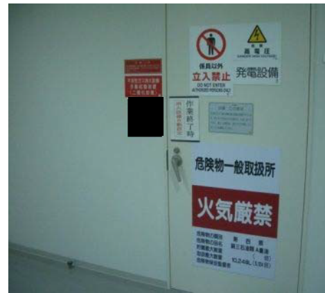
CO 2 設置室入口
