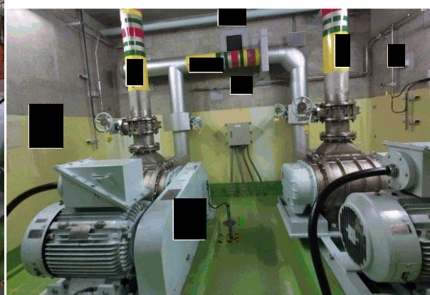
分離建屋 塔槽類廃ガス処理設備 排風機
