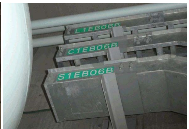
使用済み燃料受入れ・貯蔵施設用冷却 設備基礎(B) 安全系ケーブルトレイ (B) (A系は遠方にあり)
