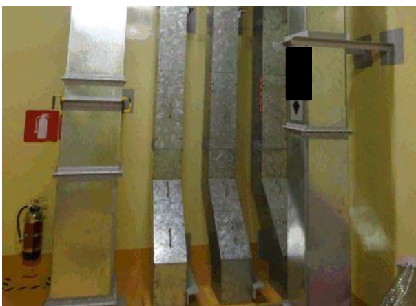
ウラン・プルトニウム混合酸化物貯蔵建屋 安全系ケーブルトレイ (A) (カメラ死角に B 系あり)
