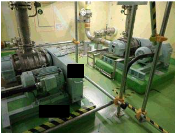
精製建屋 パルセータ廃ガス処理設備 排風機
