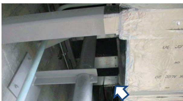
前処理建屋 安全系ケーブルトレイ (A) (カメラ死角に B 系あり)
