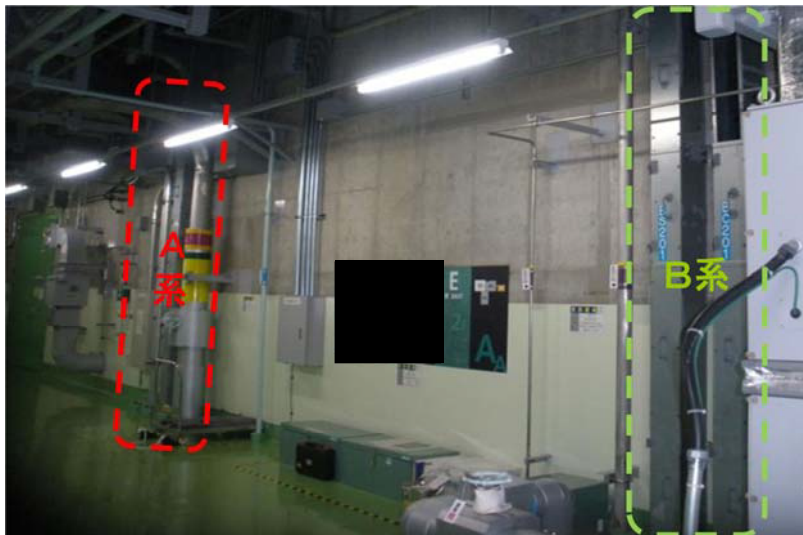
第3図 安全上重要なケーブルの分離例 （前処理建屋 地上2階南北第1廊下）
