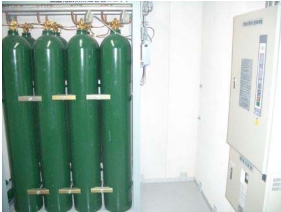
CO 2 ボンベ設置状況
