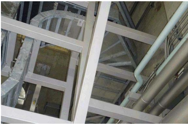
ウラン・プルトニウム混合脱硝建屋 安全系ケーブルトレイ (B) (カメラ死角に A 系あり)
