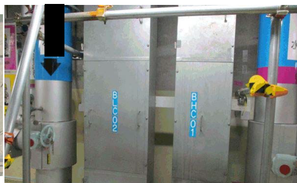
前処理建屋 安全系ケーブルトレイ (B) (カメラ死角に A 系あり)
