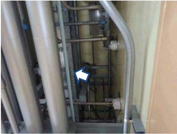
精製建屋 安全系ケーブルトレイ (B) (カメラ死角に A 系あり)
