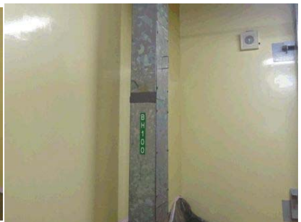
ウラン・プルトニウム混合酸化物貯蔵建屋 安全系ケーブルトレイ (B) (カメラ死角に A 系あり)
