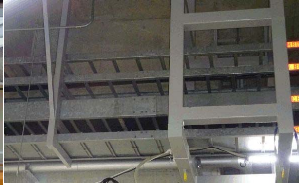
ウラン・プルトニウム混合脱硝建屋 安全系ケーブルトレイ (A) (カメラ死角に B 系あり)
