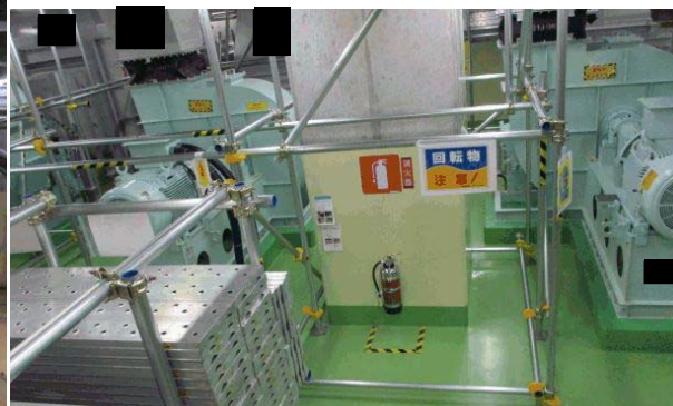
前処理建屋換気設備 セル排風機
