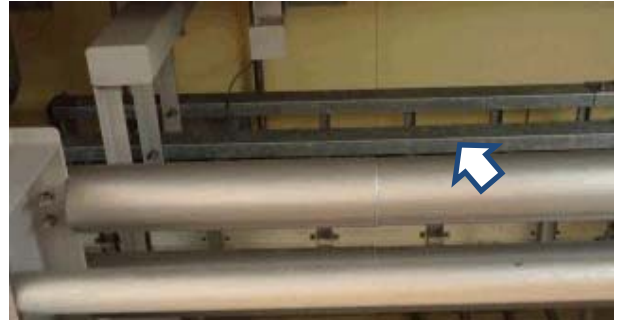
精製建屋 安全系ケーブルトレイ (A) (カメラ死角に B 系あり)
