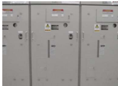
第8図 ガス遮断器
