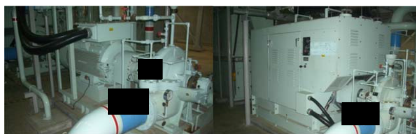
電動機駆動消火ポンプ
