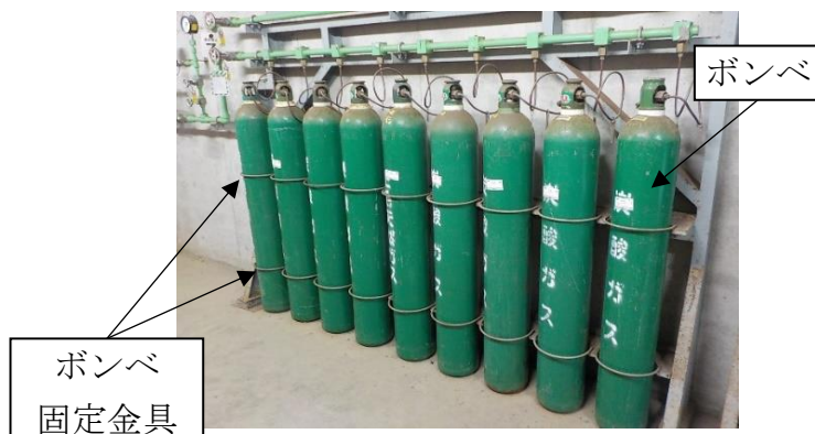
【7号炉ポンベ建屋】 二酸化炭素ポンベ
