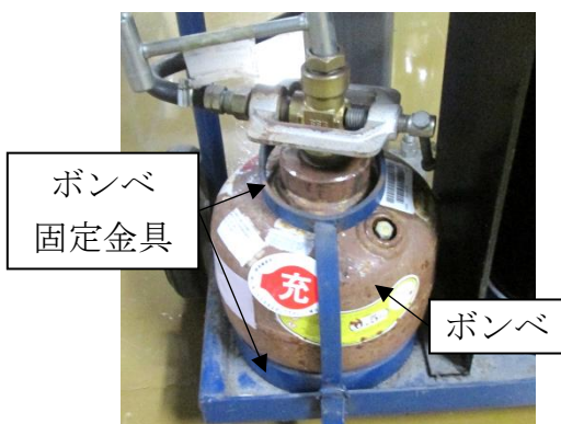
【技能訓練施設技能訓練棟】 アセチレンポンベ
