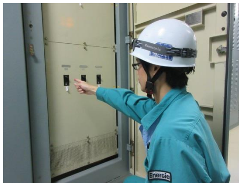
電源切替操作
