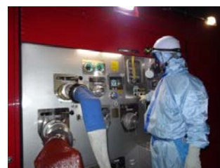
ポンプ起動操作（夜間）
