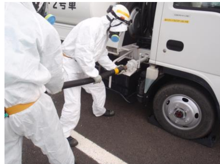
タンクローリへのホース接続
