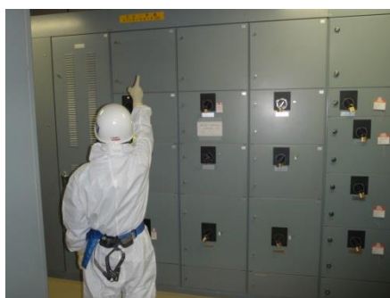
電源開放操作
