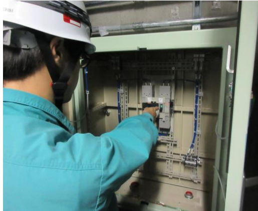
電源切替操作
