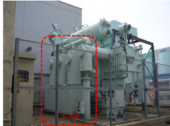
受電変圧器（露出部無し）
