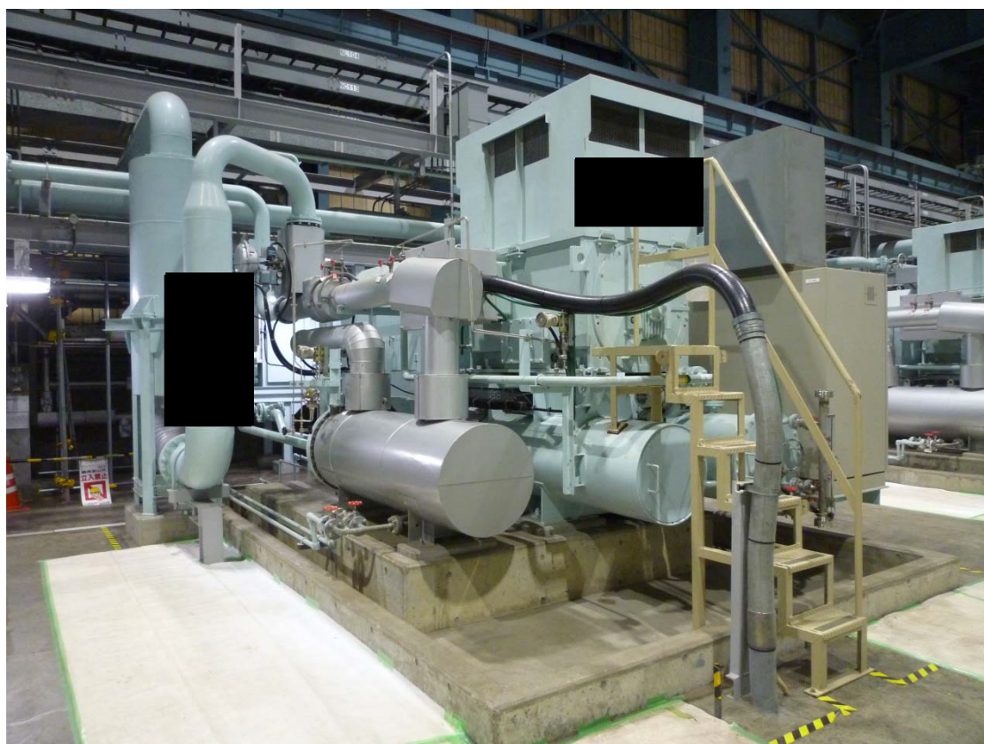
写真：緊急遮断弁の駆動源となる空気圧縮機
