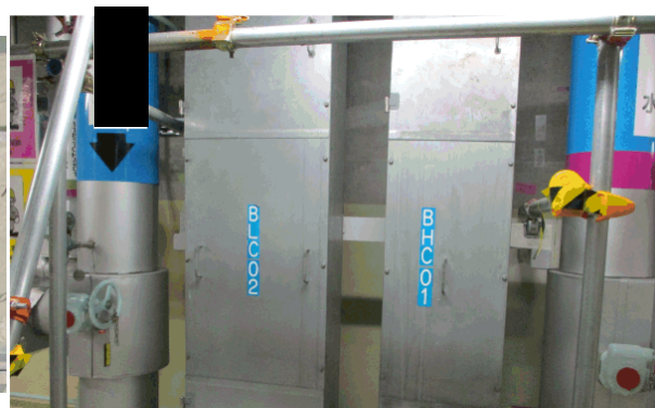
前処理建屋 安全系ケーブルトレイ (B) (カメラ死角に A 系あり)
