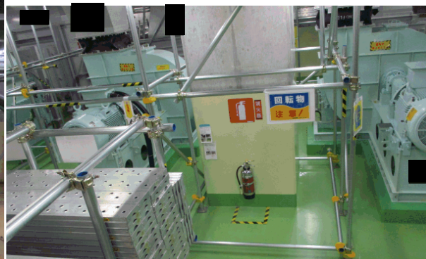
前処理建屋換気設備 セル排風機
