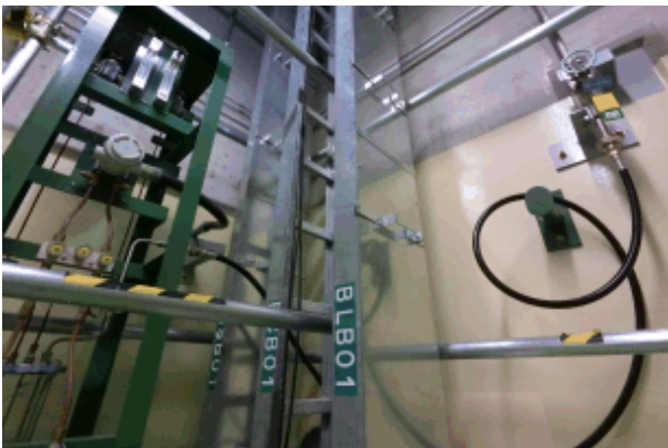
分離建屋 安全系ケーブルトレイ (B) (A系は遠方にあります)
