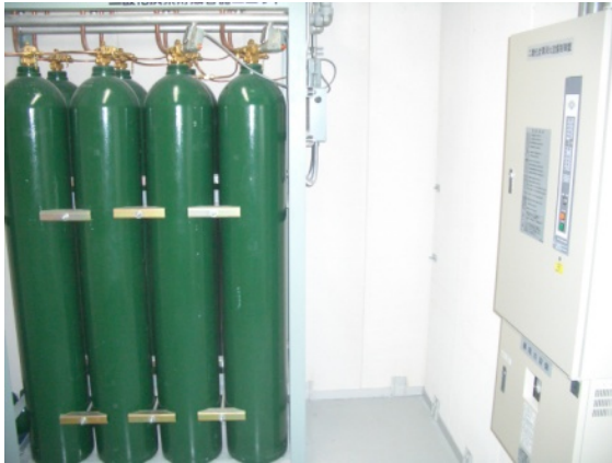
CO 2 ボンベ設置状況
