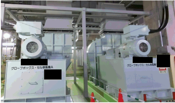
分離建屋換気設備 グローブボックス・セル排風機
