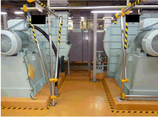
ウラン・プルトニウム混合脱硝建屋 グローブボックス・セル排風機
