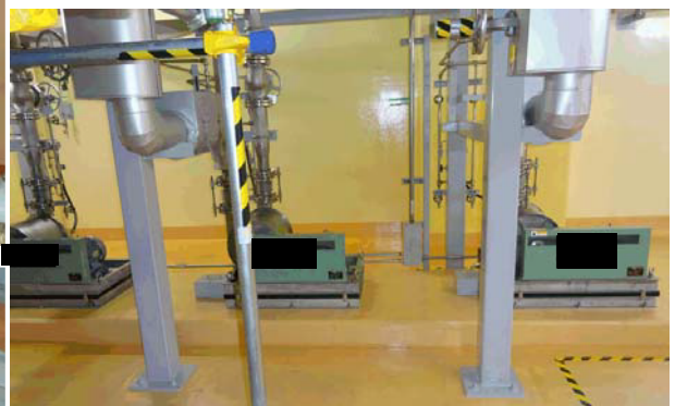
ウラン・プルトニウム混合脱硝建屋 塔槽類廃ガス処理設備 排風機
