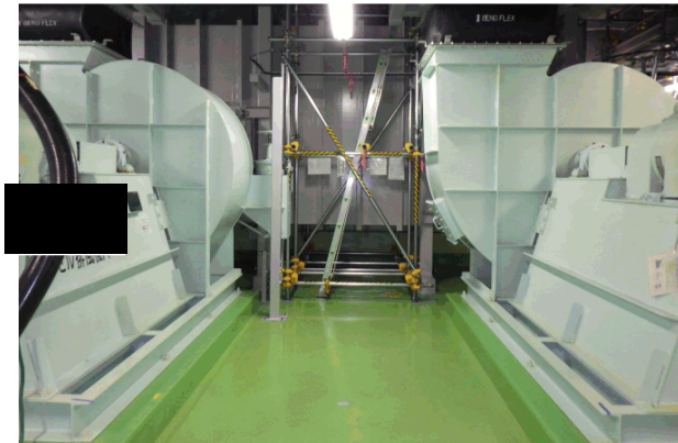
高レベル廃液ガラス固化建屋 換気設備 セル排風機
