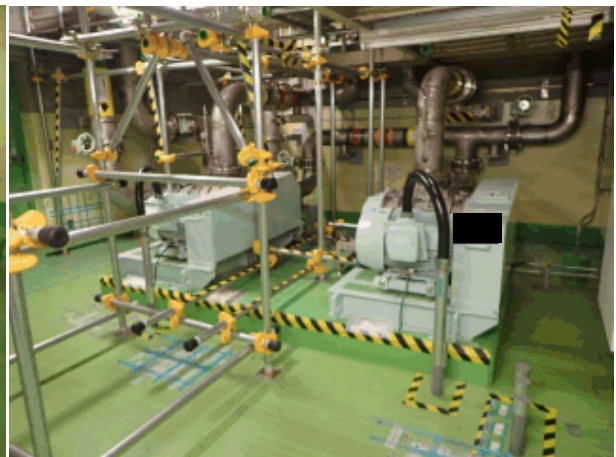
精製建屋 塔槽類廃ガス処理設備(Pu系) 排風機
