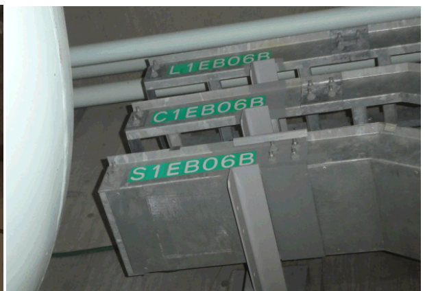
使用済み燃料受入れ・貯蔵施設用冷却 設備基礎(B) 安全系ケーブルトレイ (B) (A系は遠方にあり)
