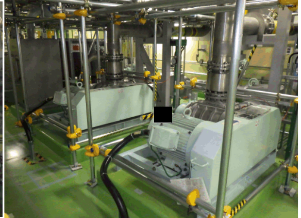
高レベル廃液ガラス固化建屋 塔槽類廃ガス処理設備 排風機
