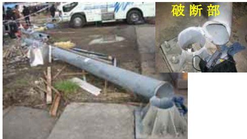
倒壊した道路標識支柱
