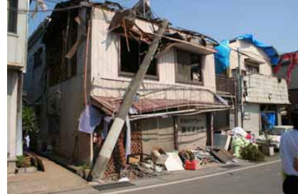
倒壊電柱に直撃された家屋
