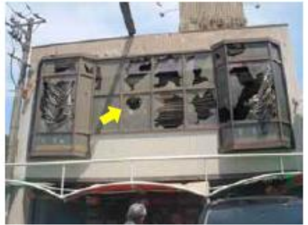
店舗の窓ガラスの被害状況
