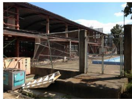
フェンスの変形（工事中の建築物）
