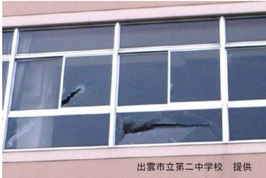
体育館窓ガラスの損傷
