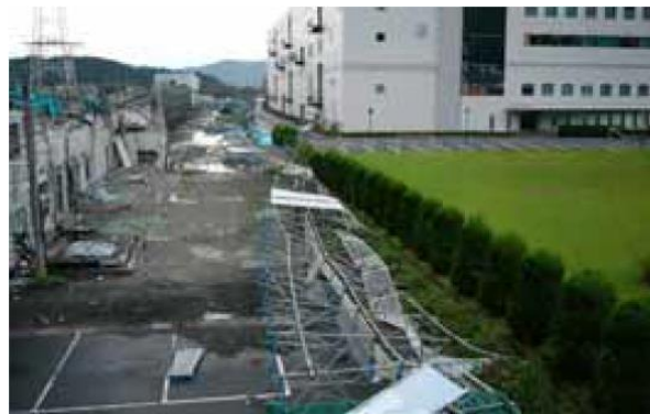
第 29 図 平成 18 年 9 月 17 日宮崎県延岡市で発生した F 2 竜巻による仮設足場の被害状況 (11)
