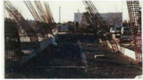
曲がった鉄筋（工事現場）
