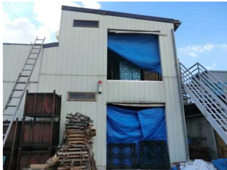
シャッターの外れ
