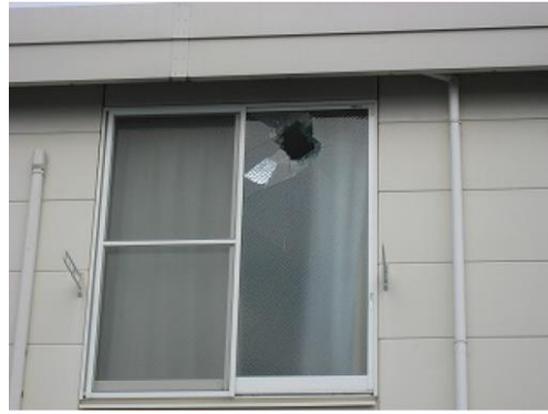
窓ガラスの飛来物衝突痕
