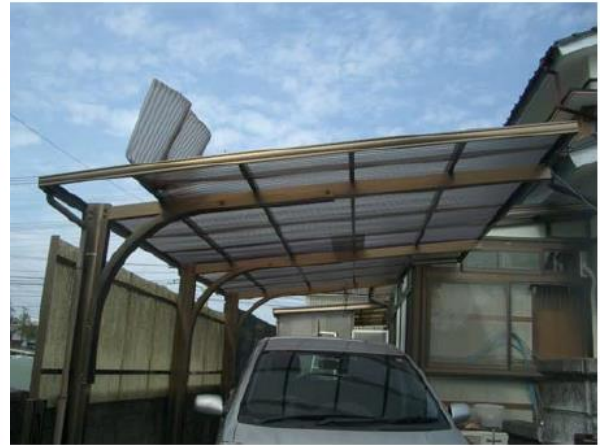
カーポート屋根の損傷
