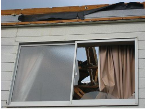
窓ガラスの損壊
