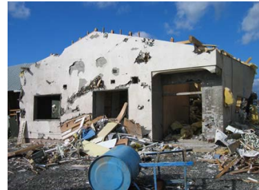
飛来物による被害を受けた建物
