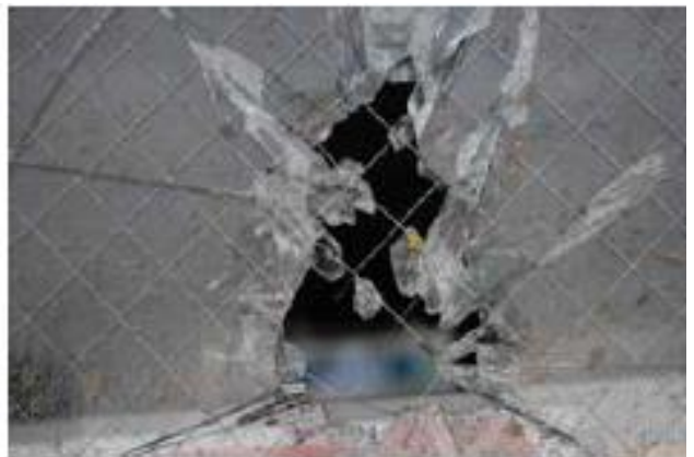
ガラスの被害状況（飛来物衝突痕）
