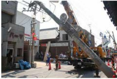
倒れた電柱(復旧作業時)
