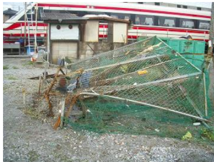
フェンスの著しい変形
