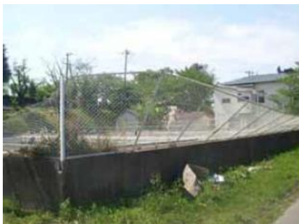
フェンスの変形
