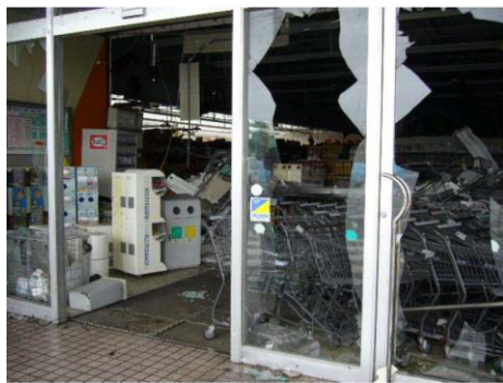
エントランスの窓ガラスの破損
