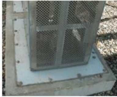
第 3-3-3 図 受電開閉設備のパンチング部分 (小動物対策)
