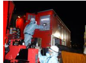
ポンプ起動操作 (夜間)
