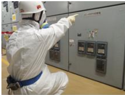
遮断器手動投入
