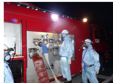
ポンプ起動操作（夜間）
