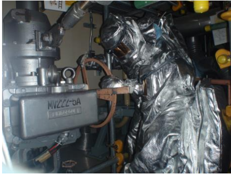
残留熱除去系注水弁の閉操作 (保護具着用)
