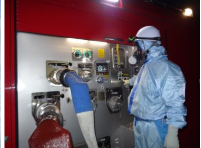
ポンプ起動操作 (夜間)
