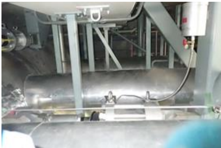
主蒸気ヘッド周辺 (600A)
