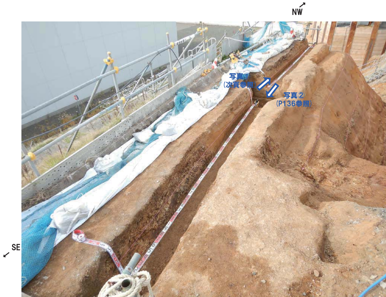
開削調査箇所(南側) 追加人力掘削調査 写真(天端南側から北側を望む)
