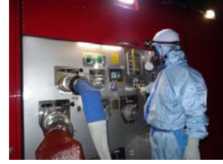
ポンプ起動操作（夜間）
