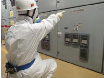
遮断器手動投入
