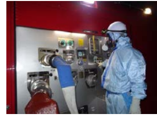
ポンプ起動操作（夜間）
