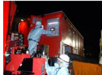
ポンプ起動操作 (夜間)
