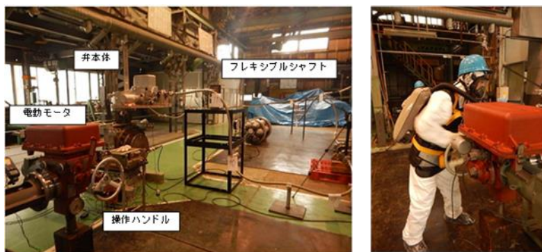
ベント操作（遠隔手動弁操作機構）
