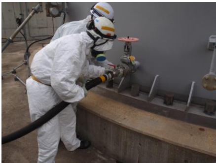
ガスタービン発電機用軽油タンクへのホース接続
