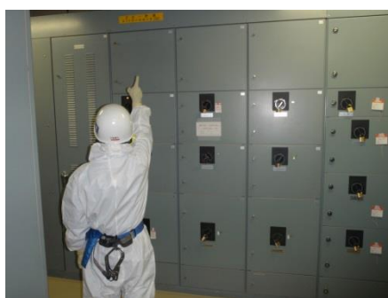
電源開放操作
