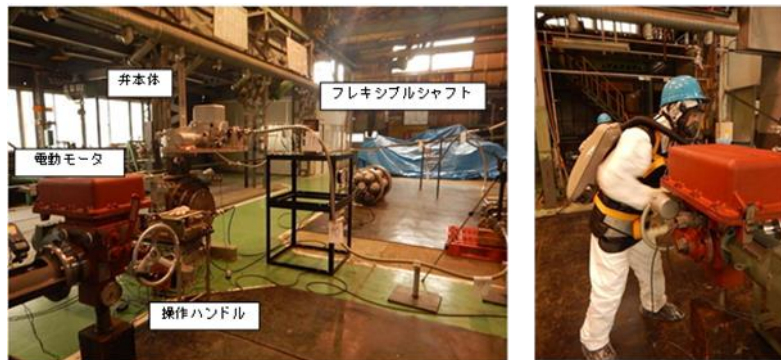
バント操作（遠隔手動弁操作機構）
