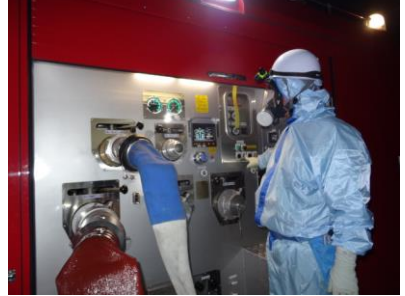
ポンプ起動操作 (夜間)
