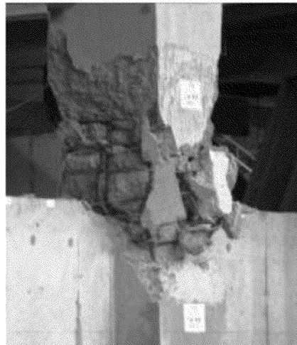
(1階柱の破壊状況)
