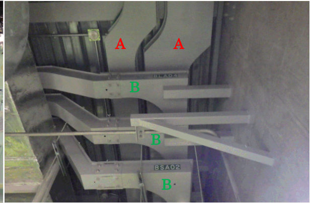
高レベル廃液ガラス固化建屋 安全系ケーブルトレイ (A/B) (A系下部にB系あり)
