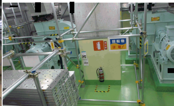
前処理建屋換気設備 セル排風機
