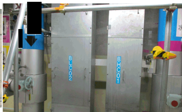
前処理建屋 安全系ケーブルトレイ (B) (カメラ死角に A 系あり)
