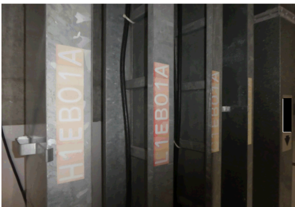
使用済み燃料受入れ・貯蔵施設用冷却 設備基礎(B) 安全系ケーブルトレイ (A) (B系は遠方にあり)
