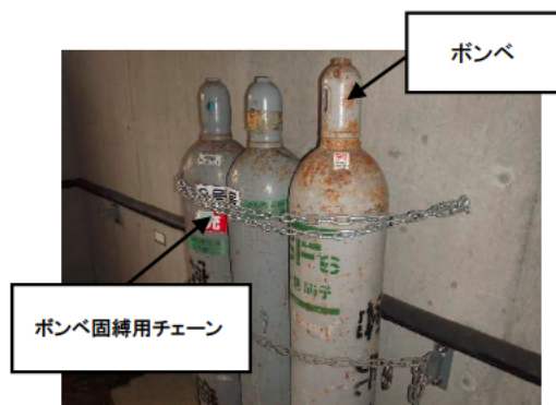
【3号炉ガス倉庫】
