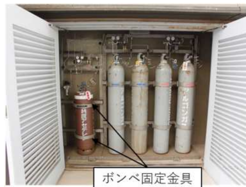
アセチレン (タービン建屋)
