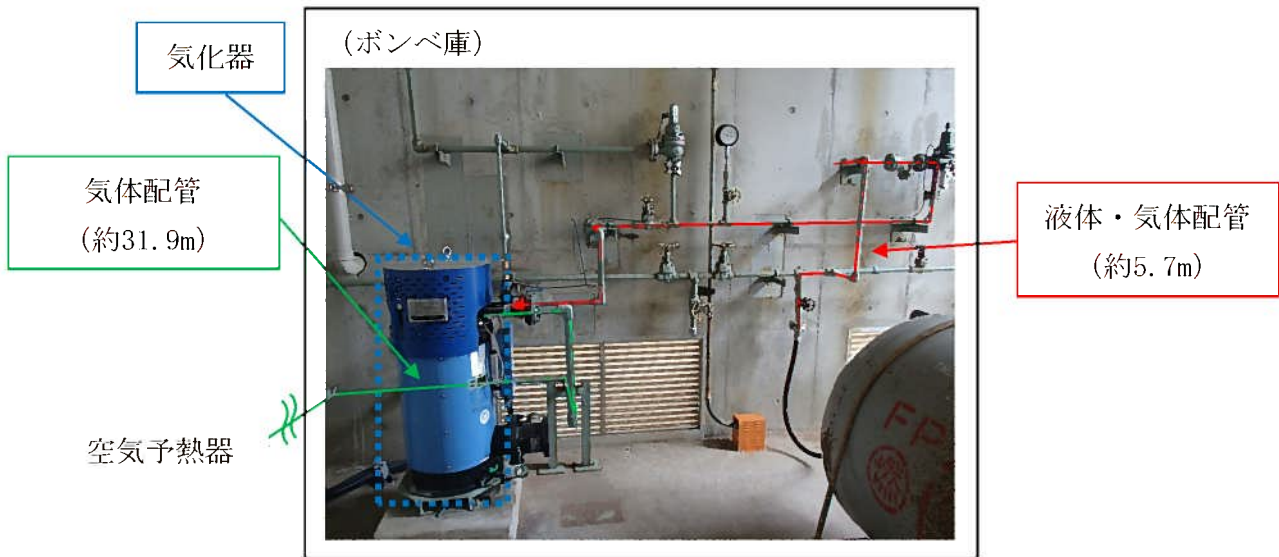
図 雑固体焼却設備のプロパンボンベ気化器周りの現場状況
