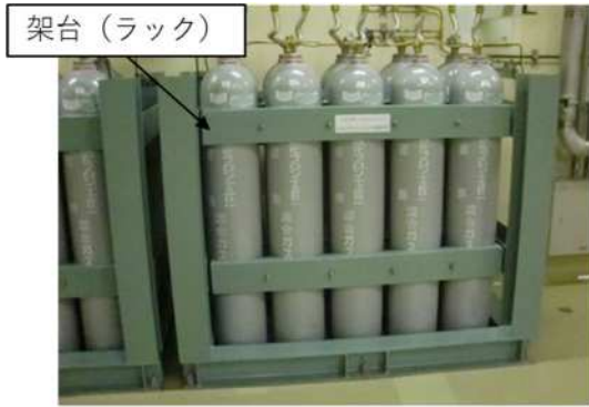
ハロン 1301 (3号原子炉周辺建屋)
