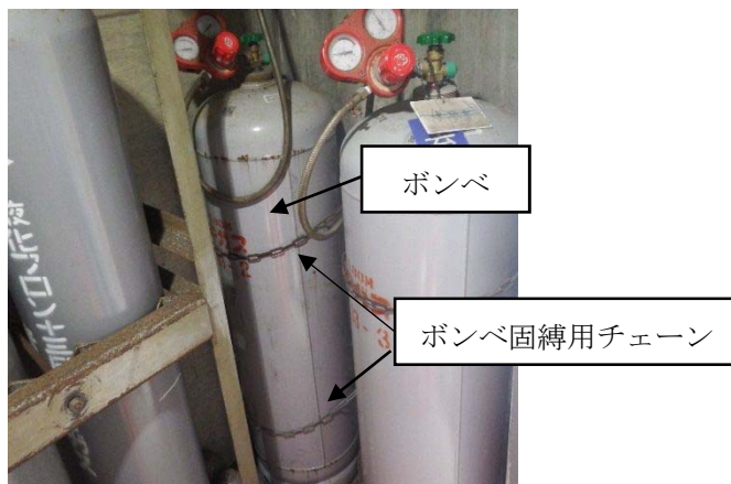
1, 2号炉 補助ボイラ室 補助ボイラ用プロパンガス
