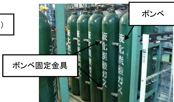
大飯3号炉 タービン建屋 液化炭酸ガス (消火設備)
