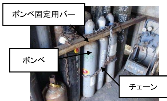
大飯発電所 協力会社ボンベ庫 六フッ化硫黄 (補充用)
