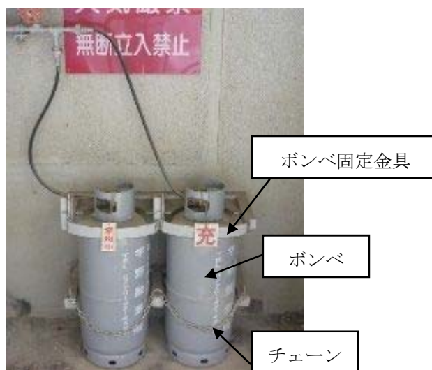
3号炉 補助ボイラ建屋 補助ボイラ用プロパンガス
