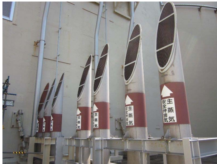
図3 主蒸気安全弁（排気管）の設置状況
