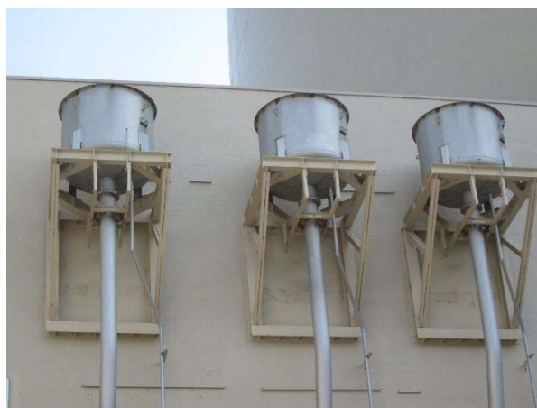
図3 主蒸気逃がし弁消音器の設置状況
