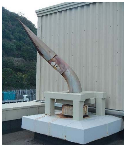
図 1 タービン動補助給水ポンプ蒸気大気放出管の設置状況
