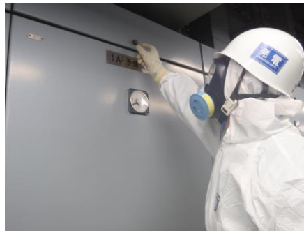
インターロック解除処置
