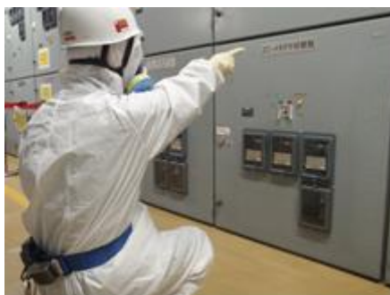
遮断器手動投入
