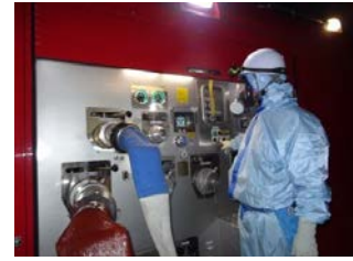
ポンプ起動操作（夜間）
