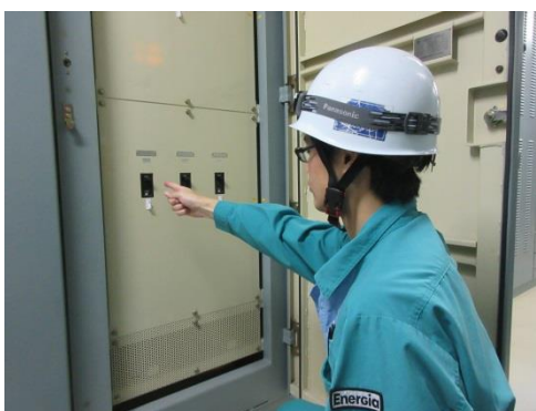
電源切替操作
