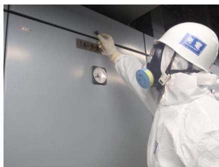
インターロック解除処置
