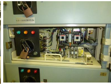
気中遮断器の例 (コントロールセンタ)
