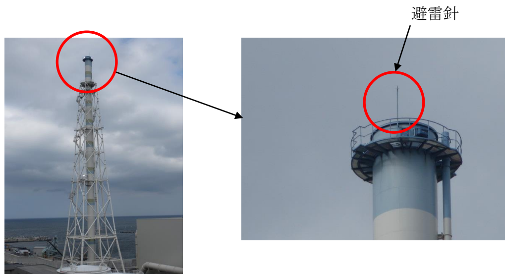
図1-15：避雷設備の設置例（排気筒）
