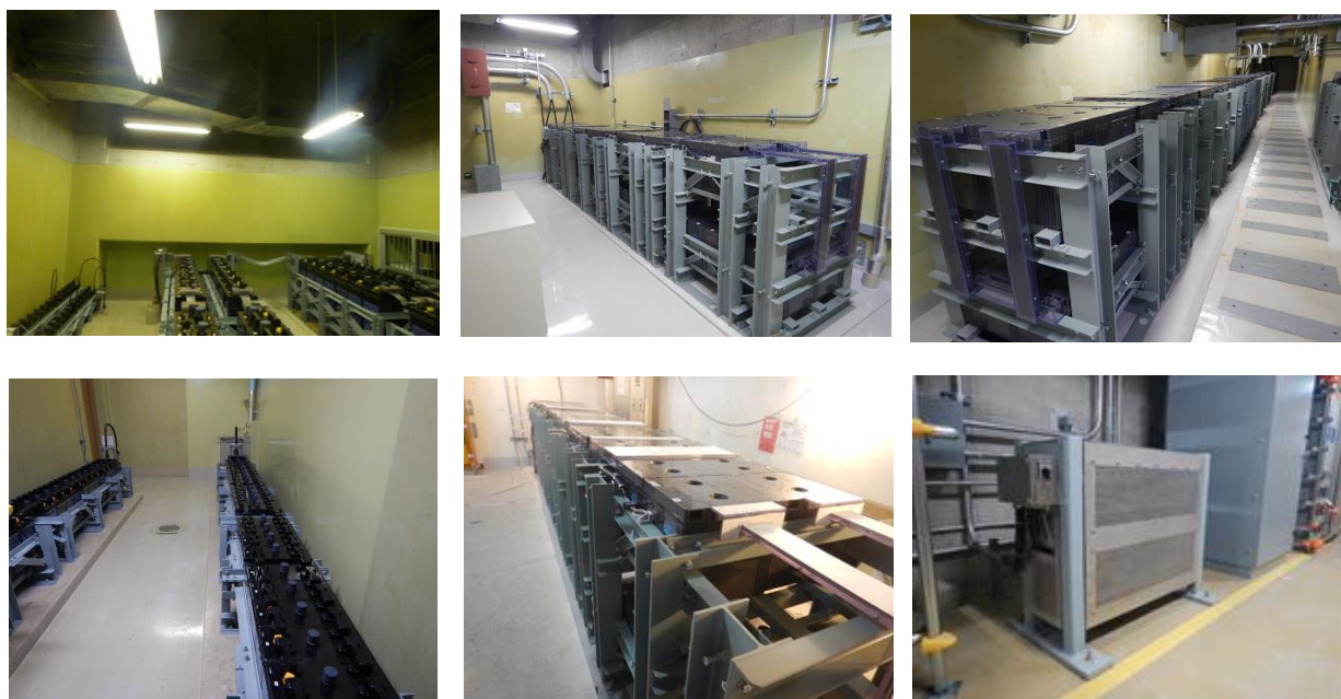
図 1-39 : 蓄電池の設置状況 (1 / 6)
